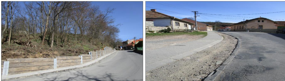
Obr. č. 24: Ochranná zeď v ulici Paseky (vlevo), stav hlavní komunikace (vpravo)
